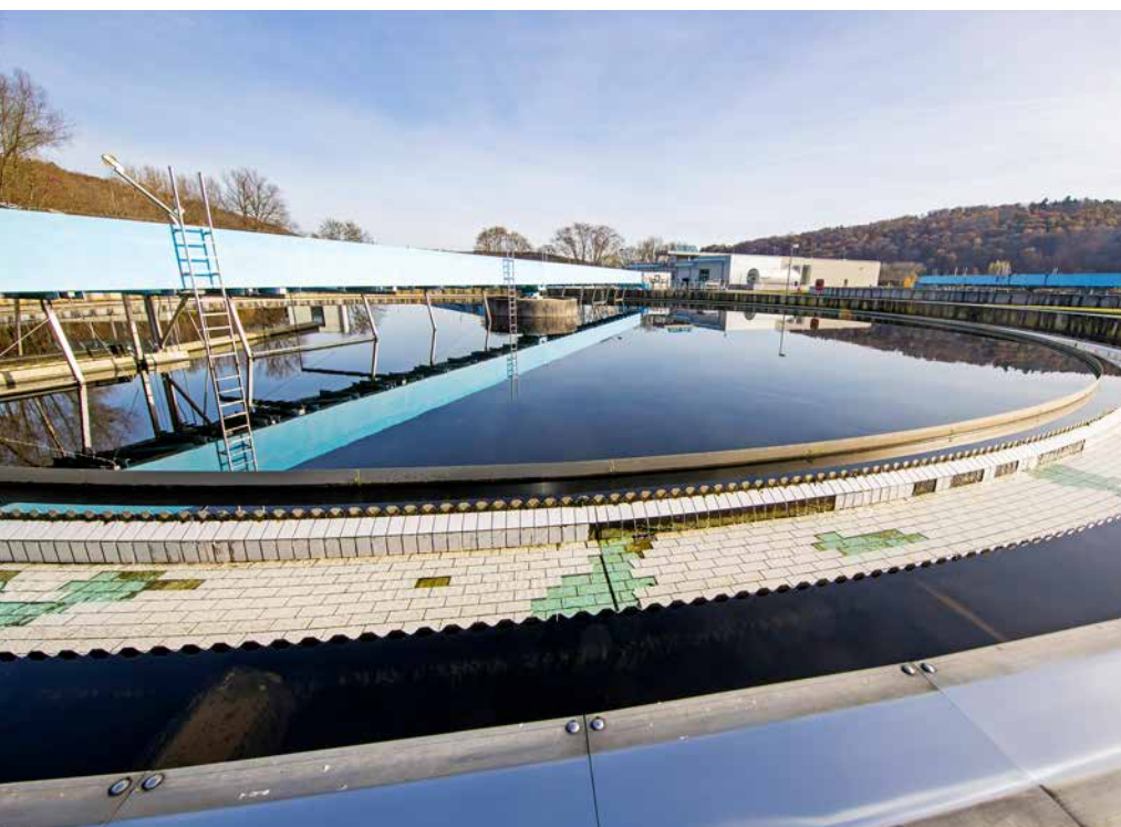
Blick auf die Nachklärung als vorletzten Prozessschritt auf der Kläranlage Tübingen
