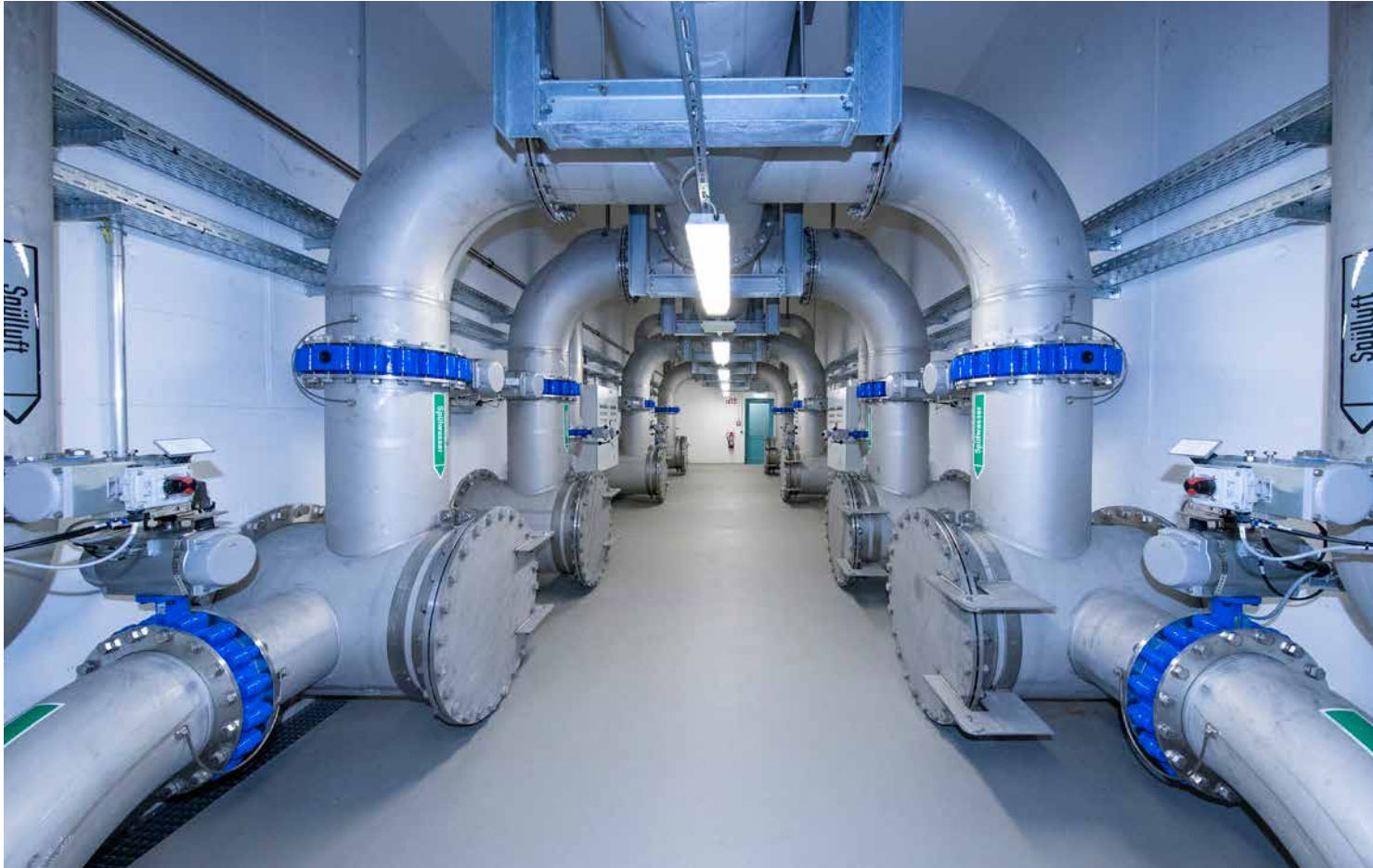
Blick in die Ozonung; der letzte und modernste Reinigungsschritt auf der Kläranlage Tübingen
