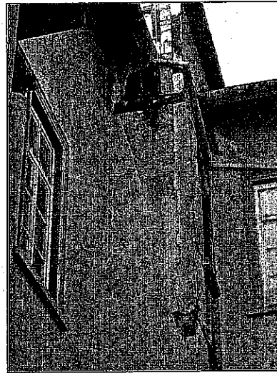
Schäden Treppenhaus außen - Südseite - rechts
