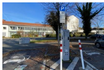
Abb. 33: Ladeinfrastruktur am Parkplatz Feuerhügge
