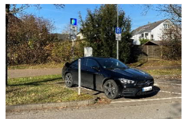
Abb. 34: Ladeinfrastruktur in der Primus-Truber-Straße
