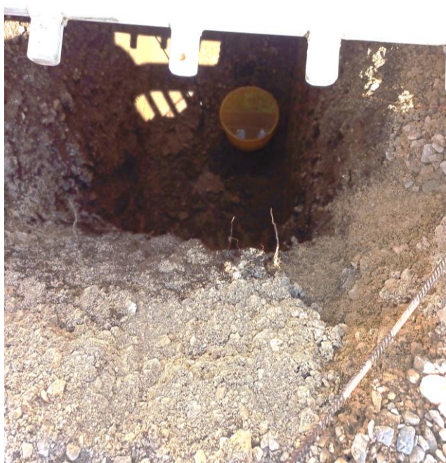
Foto Nr. 4 Versickerungsversuch SG2 – Ende 3,4 h
